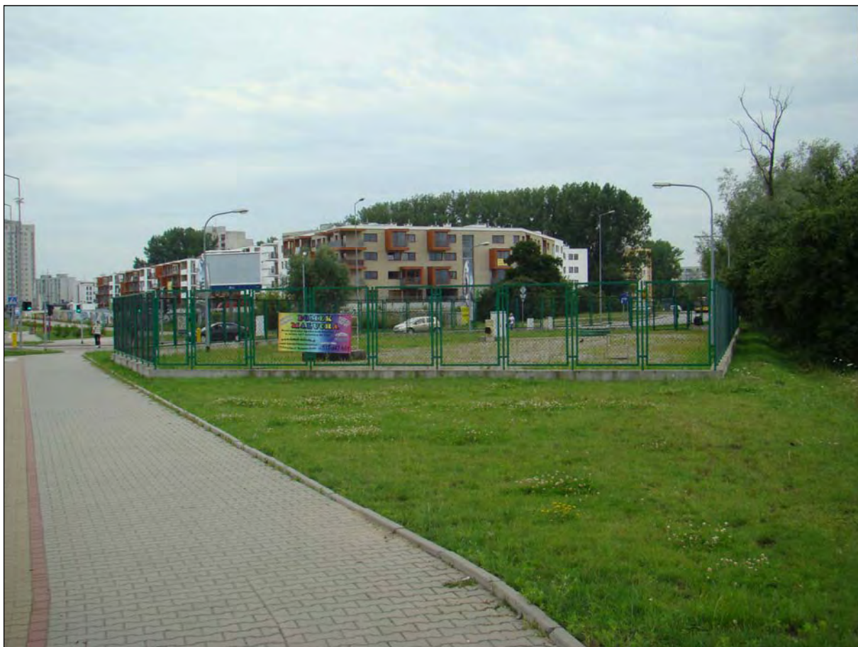
Fot. 31 Przepompownia wód deszczowych przy ul. Malborskiej
