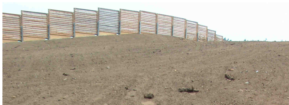
Przejście górne dla zwierząt na Autostradzie A-2 w Polsce w trakcie budowy
