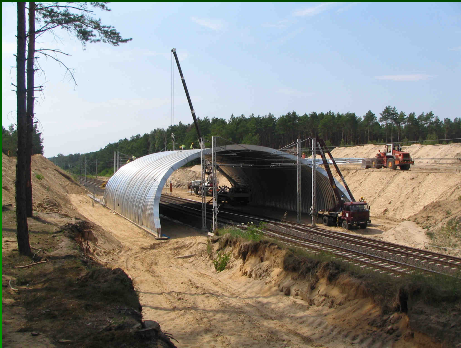
Linia kolejowa E20 w km 466+778 – budowa przejścia dla zwierząt (fot. K. Czechowski)
